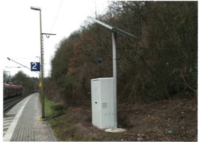
Abb. 6: Off-Grid Box in Friedelhausen (bei Gießen) zur Versorgung eines doppelseitigen Dynamischen Schriftanzeigers Quelle: Marcus Klaer
