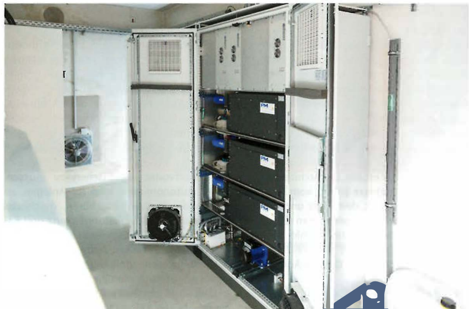
Abb. 2: „Power-Unit“ 25 kW Brennstoffzellen-Netzersatzanlage im Stellwerk Sömmerda (Thüringen), Indoor-Anlage
