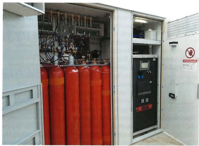
Abb. 4: „Power-Unit“ 6 kW Brennstoffzellen-Netzersetzanlage für Funkstandorte, Outdoor-Anlage Quelle: Frank Luckau
