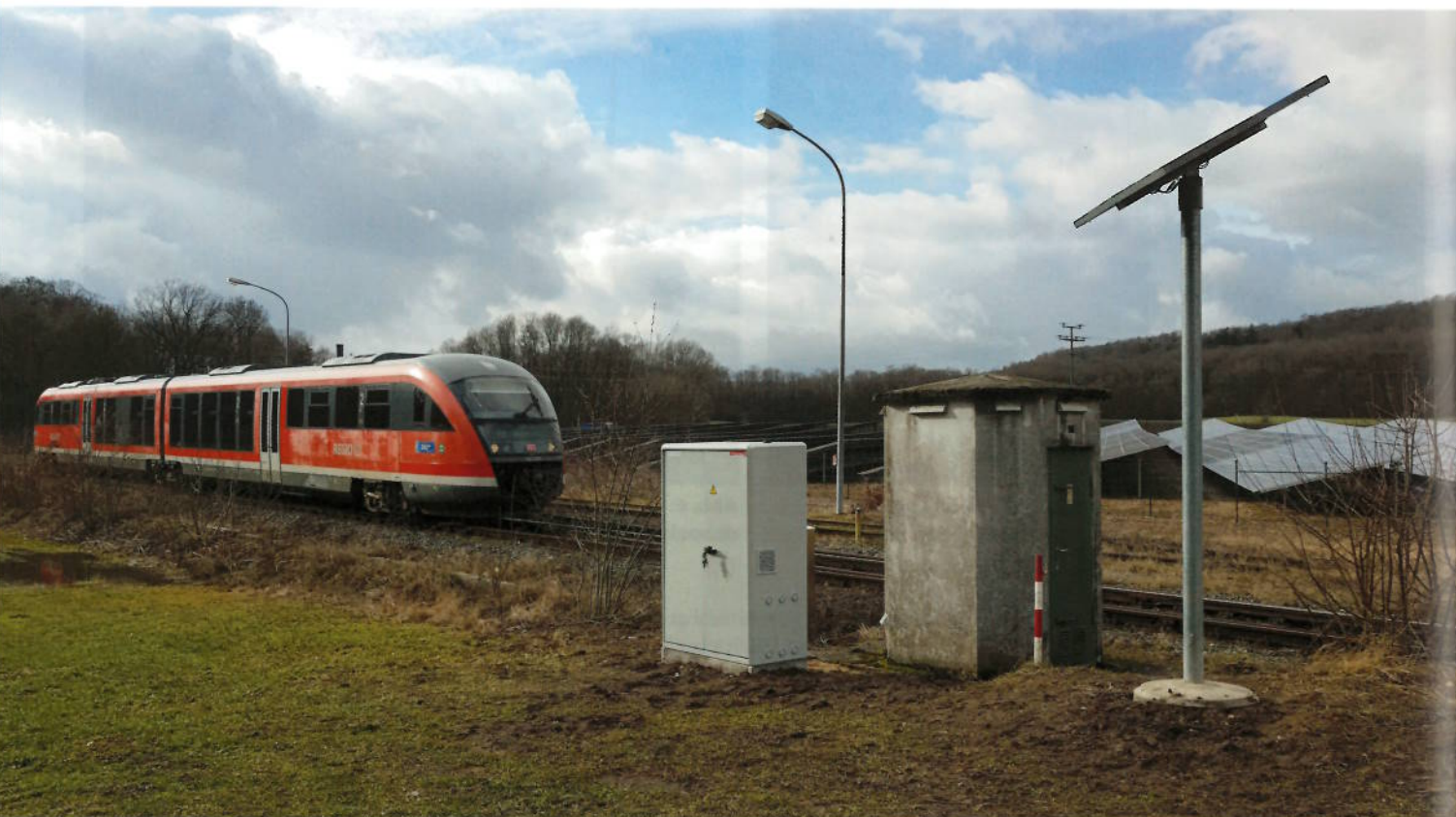
Abb. 7: Off-Grid Box Nähe Rothenburg o. d. T. zur Versorgung einer TUZ-Anlage
