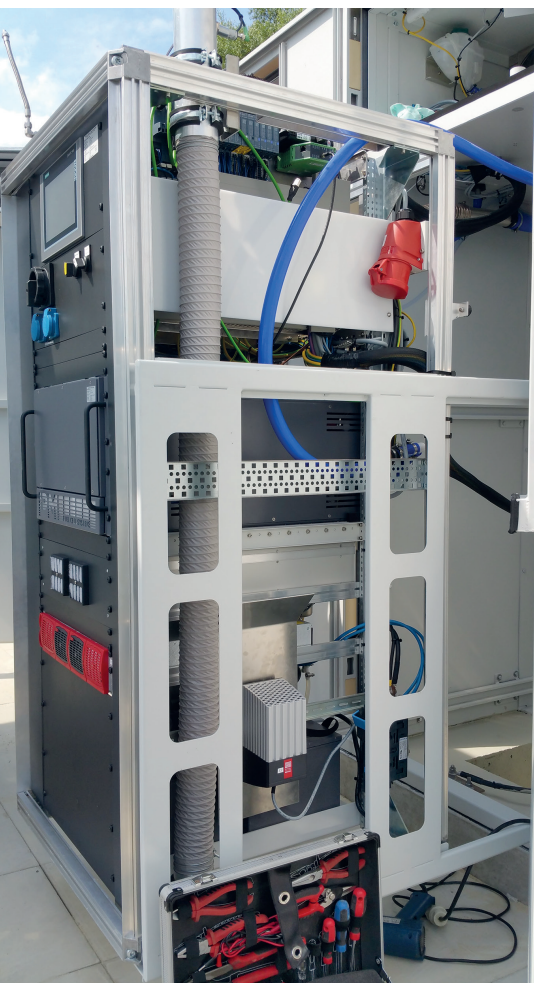
Abb. 1: Brennstoffzellen-Compartment für eine 6 kW-Brennstoffzellen-NEA
