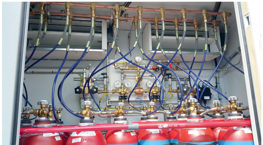
Abb. 2: PEMFC – Wasserstoffanschluss für eine 6 kW-Brennstoffzellen-NEA
